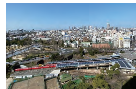
丸ノ内線四ツ谷駅の太陽光パネル
